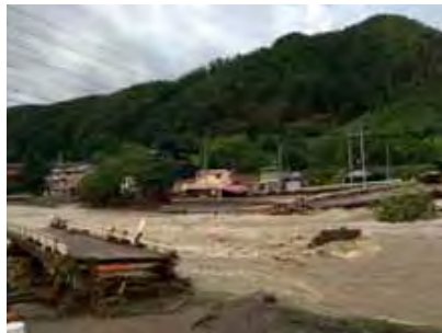
台風10号の洪水で流された宮古市茂市地区の日陰橋
