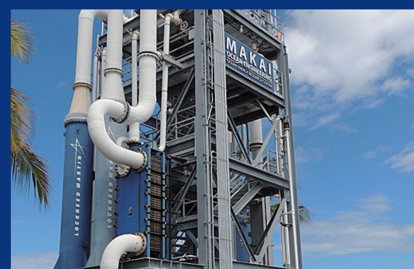
海洋温度差発電施設
