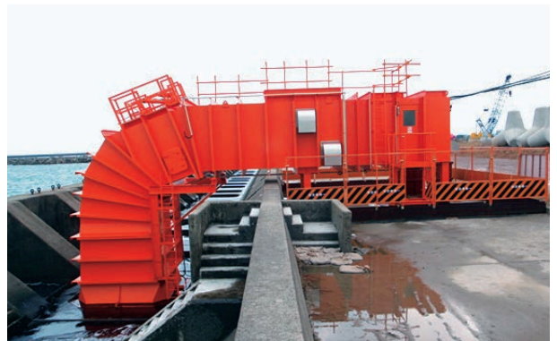
設置された空気タービン式波力発電システム
