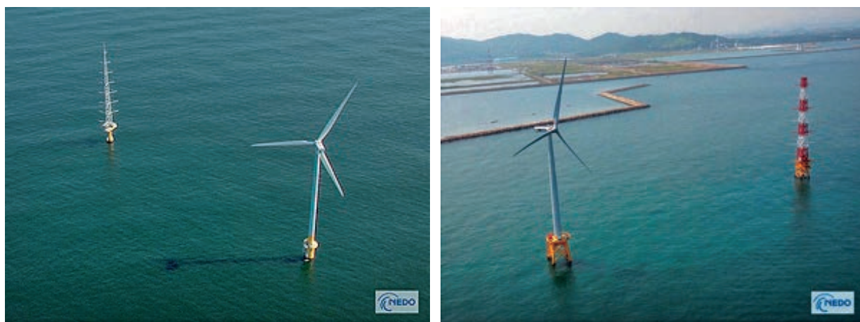
設置された洋上風車（左：銚子沖 右：北九州市沖）
