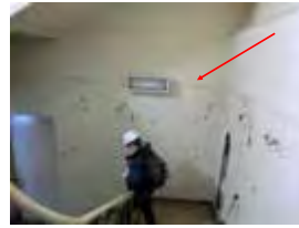
津波の痕跡の一例 (国交省釜石港湾事務所内の水跡)
