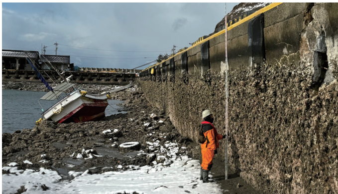
■図1 約4m隆起した輪島市門前町鹿磯漁港の様子
