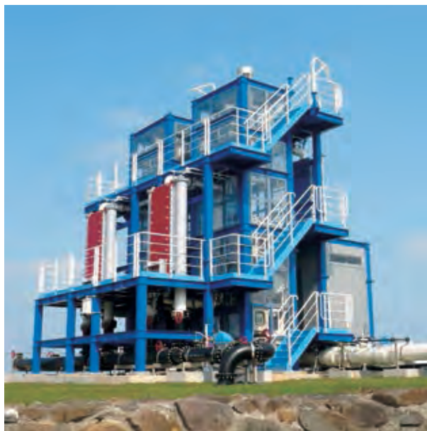
海洋温度差発電 (OTEC) の実証プラント (写真提供: 沖縄県)
